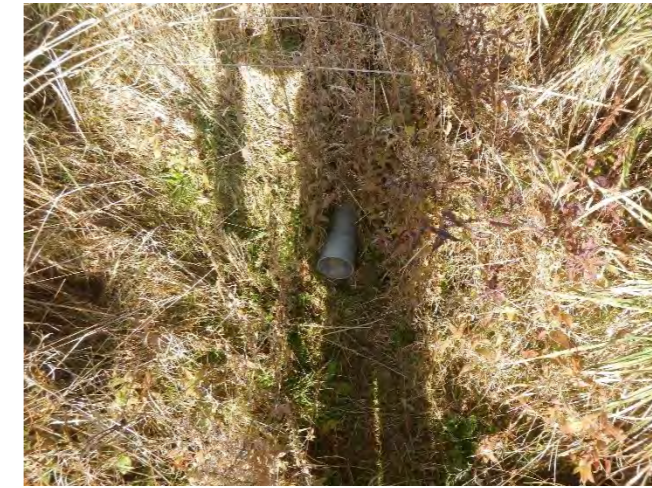
Photo 8 : Exutoire du drainage de la parcelle d'implantation de l'éolienne E2
